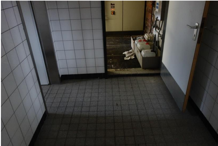
Blick durch brandschutztechnisch nicht qualifizierte Türtechnik auf Gitterrost-Podest, links Zugang WC
