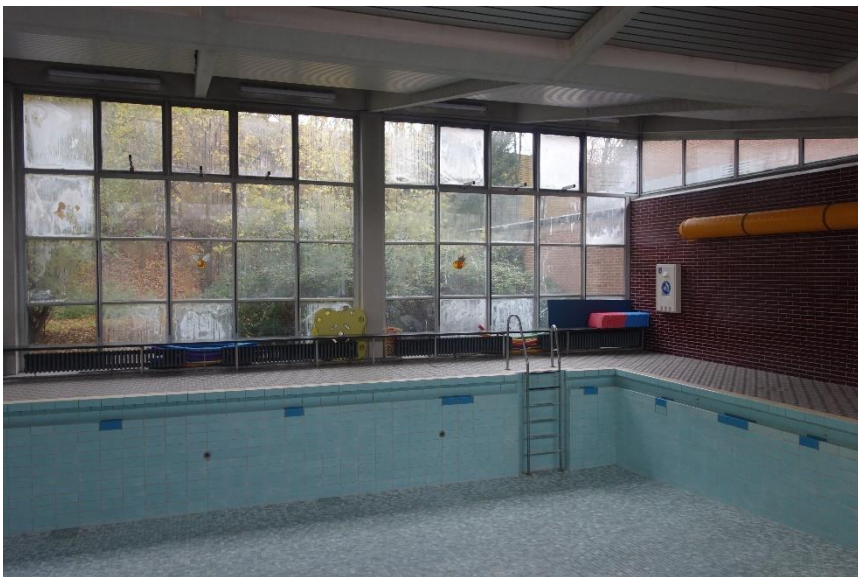
Einblick Lehrschwimmhalle mit erkennbar blinden, defekten Scheiben Vor der Alu-/Glasfassade befinden sich Heizkörper mit Wärmebankauflage
