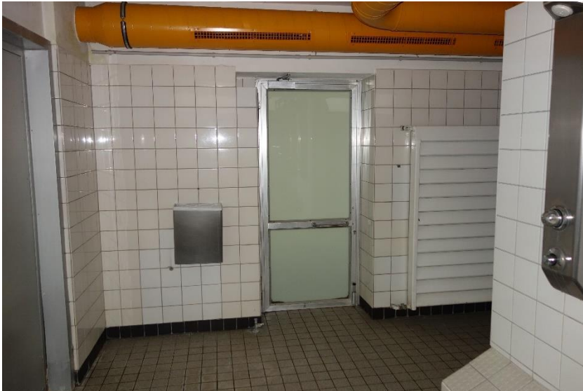
Zugangstür Umkleide / Schwimmhalle mit zu geringer Breite
