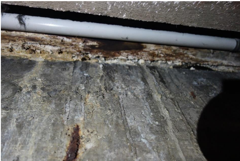
Betonschäden Beckenkörper mit korrodierter Bewehrung am Rinnenbereich
