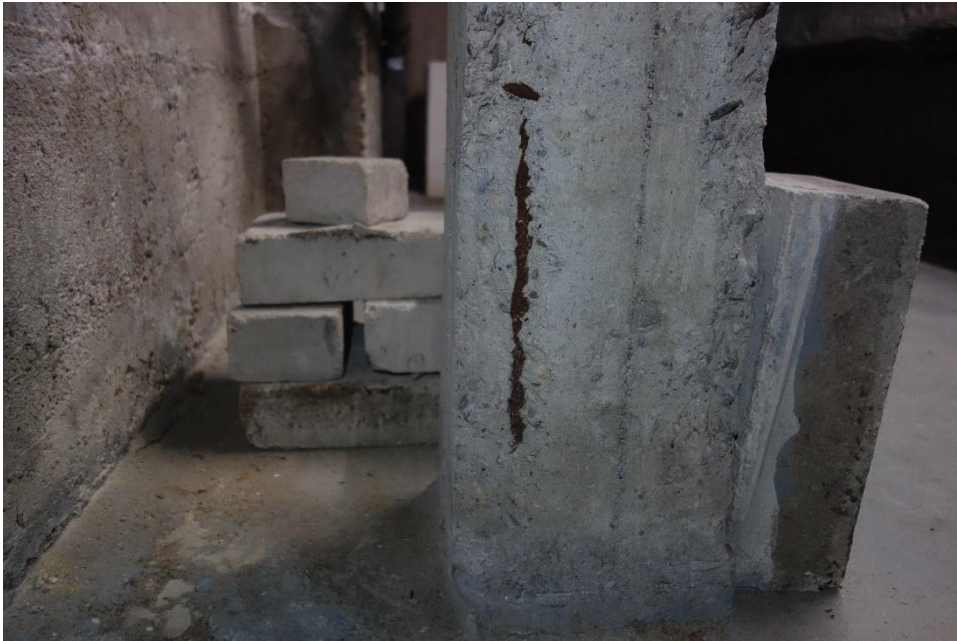
Schäden korrodierter Betonstahl Stützen
