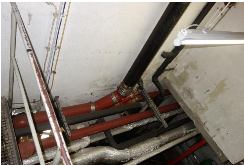
Erkennbare Feuchteschäden im Anschlussbereich Fußboden, WC an Techniktrakt
