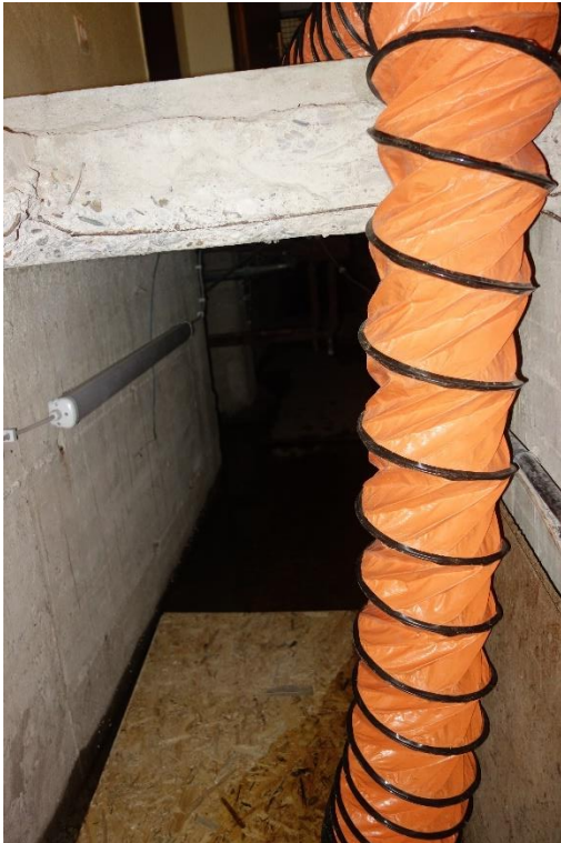
Einblick in Medienkanal mit Trocknungsschlauch
