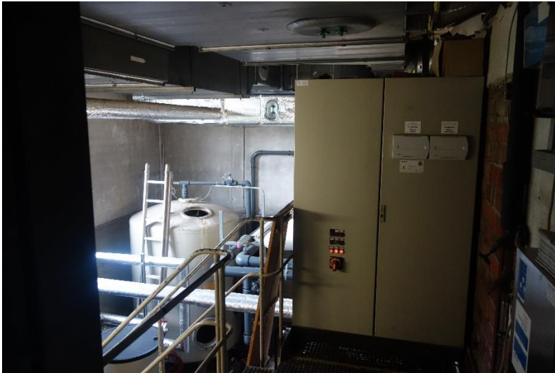
Blick von Zugangstür in 2-geschossigen Techniktrakt und geöffnetem Stahlfilter, sowie Schaltschrank
