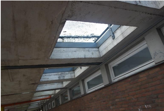
Betondecke mit Lichtkuppel vor Umkleidetrakt Lehrschwimmbecken mit sichtbaren Schäden an der Betonkonstruktion, sowie an dem offensichtlich abgängigen Holzfenster, sowie Notentwässerung unter dem Dachbereich installierten GK-Rohr
