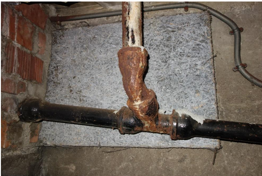
Vorgeschädigte Schmutzwasserleitungen im KG
