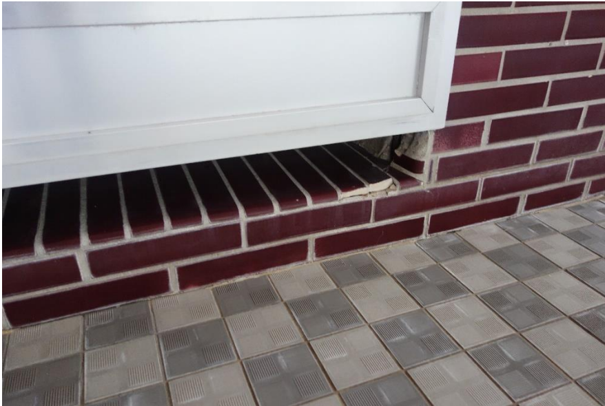
Fliesenschäden im Bereich der Heizkörpernischen
