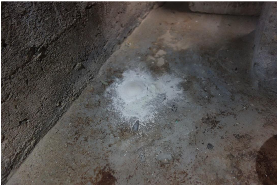
Stalagmiten-Bildung mit Kalkablagerungen aufgrund von Undichtigkeiten der Betonkonstruktion, resultierend offensichtlich aus Defekten in der Abdichtung des Beckenumganges
