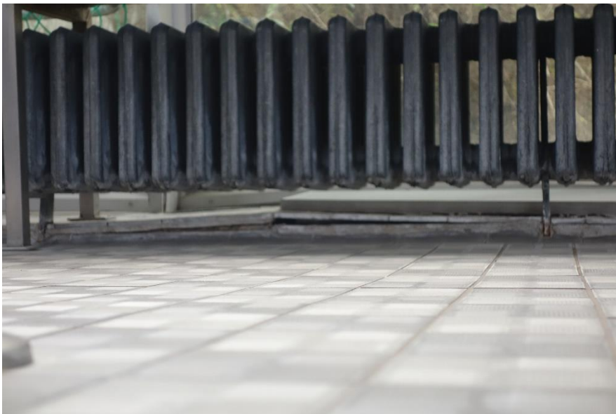
Fliesenschäden entlang Alu-/Glasfassade im Sockelbereich
