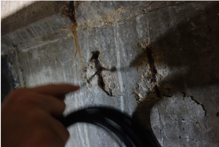
Schäden Betonkörper mit korrodierter Bewehrung
