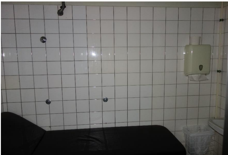
Blick in Personalraum, der offensichtlich auch als Sanitätsraum dient mit sichtbar abgebundenen, offensichtlich nicht getrennten, abgestopften Wasseranschlüssen (Verkeimungsgefahr)
