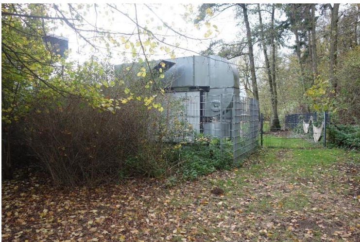
Neben dem Gebäude freistehend errichtete Lüftungsanlage
