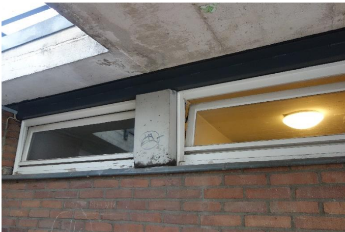
Geschädigte Holzfenster, sowie offensichtliche Feuchteschäden im Dachbereich des Pausenganges
