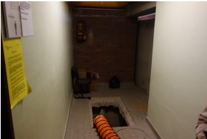
Im Bereich der Eingangszone ist der Medienkanal zum Besichtigungszeitpunkt geöffnet gewesen. Hier kam es offensichtlich zu einem Rohrleitungsschaden mit der Konsequenz, dass dieser zu beseitigen war und Trocknungen stattfinden mussten.
