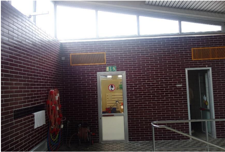
Zugangstür Personalraum / WCs mit erkennbar schmalen Breiten
