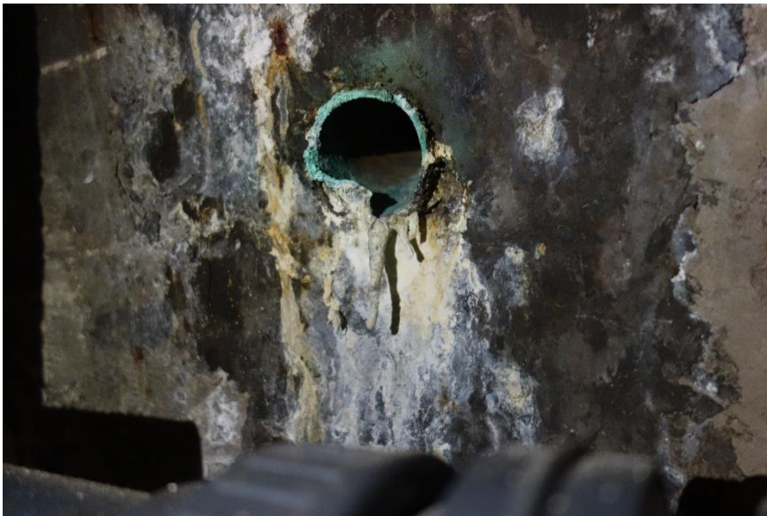
Betonschäden Beckenkörper mit nicht nachvollziehbar abgebundenem, korrodierten Kupferrohr
