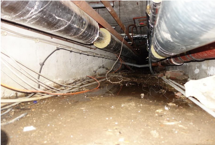
Sehr heterogene Elektroinstallation im Medienkanal, sowie offensichtlich ankorrodierte Kaltwasserleitung
