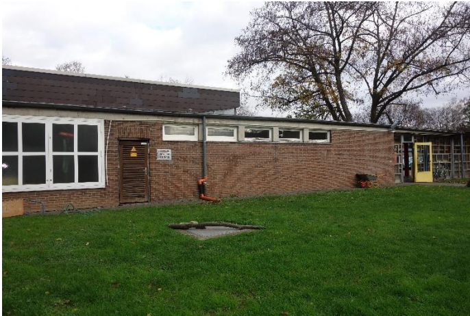
Rückwärtiger Fassadenbereich Nebenraumtrakt Lehrschwimmbecken mit nur teilweise ausgewechselten Fenstern, rechter Bereich Holzfenster, abgängig
