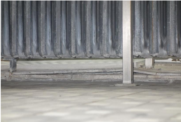
Fliesenschäden unter Heizkörper / Fassadenanschluss
