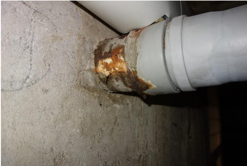
Korrosionsschäden Leitungssystem KG
