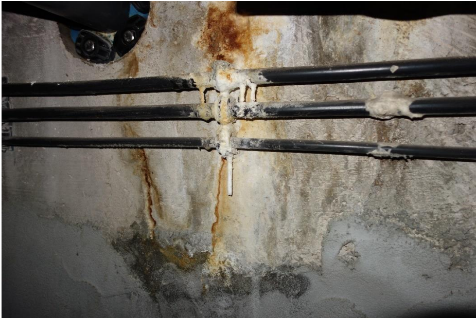
Kalkablagerungen aufgrund vorhandener Undichtigkeiten an im KG verlaufenden Installationen
