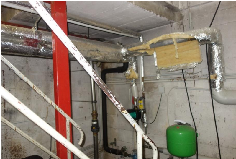
Teilweise defekte Manteldämmung Rohrinstallation
