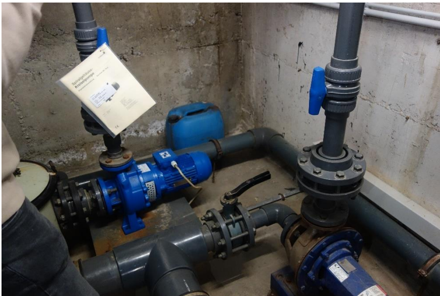
Sichtbare Betonschäden in Raumecke hinter Pumpe mit freiliegender Mat- tenbewehrung
