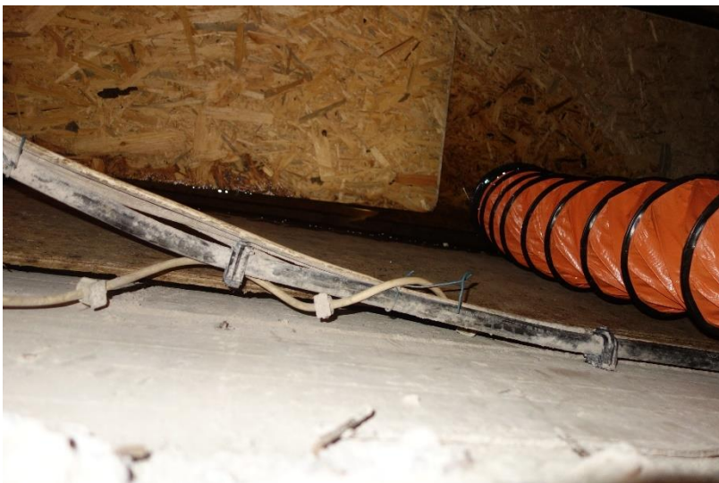
Sichtbar angestautes Wasser im Medienkanal mit heterogen installierter Elektroinstallation
