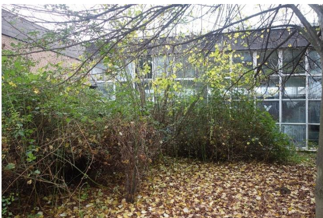
Rückwärtige Fassade Schwimmhalle mit erkennbaren Schäden an der Verglasung
