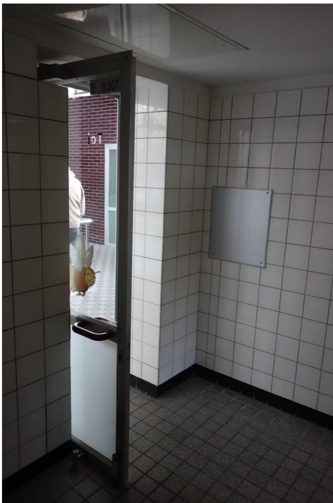
Türverbindung WC zur Schwimmhalle
