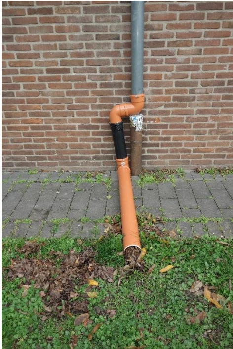
Offensichtlich inaktive Regenentwässerung mit installierter „Notentwässerung“ auf das Gelände
