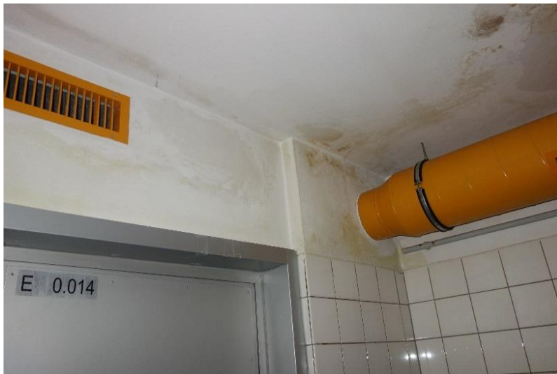
Feuchteschäden Umkleidetrakt im Deckenbereich mit Schwarzsimmelbildung
