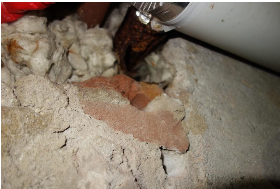
Korrosionsschäden Leitungssystem KG
