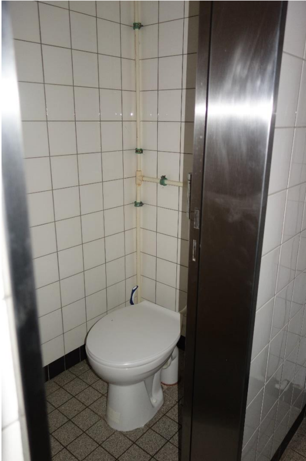
Einblick in Personal-WC mit Auf-Wand-Installation
