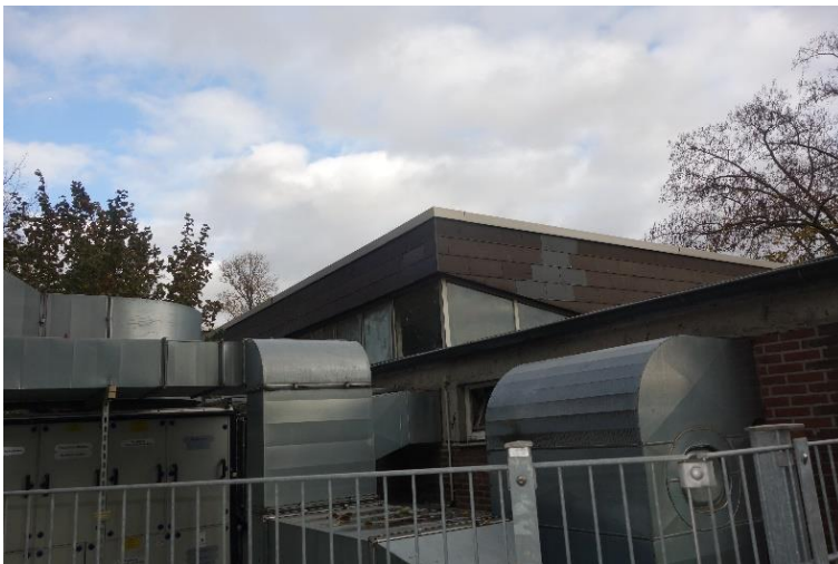
Blick auf Fensterbänder Schwimmhalle mit geschädigtem Lichtbandelement
