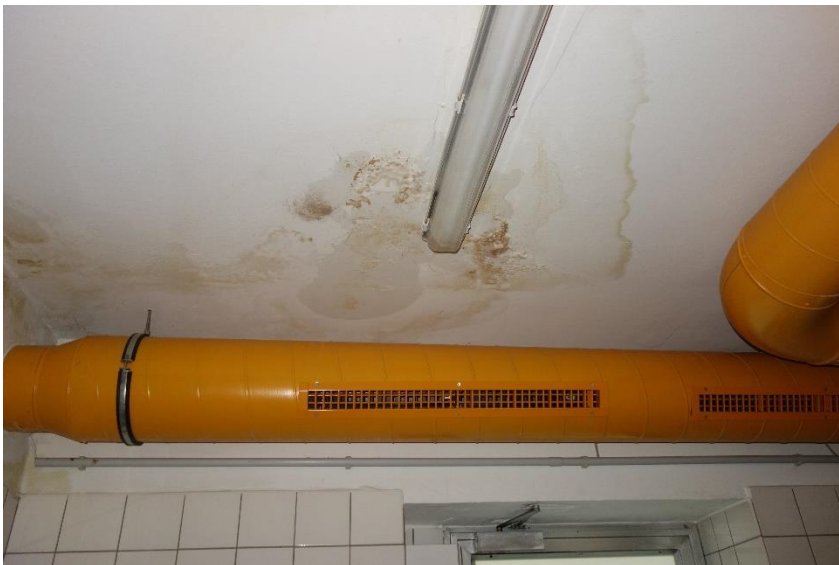
Feuchteschäden im Deckenbereich Umkleidetrakt
