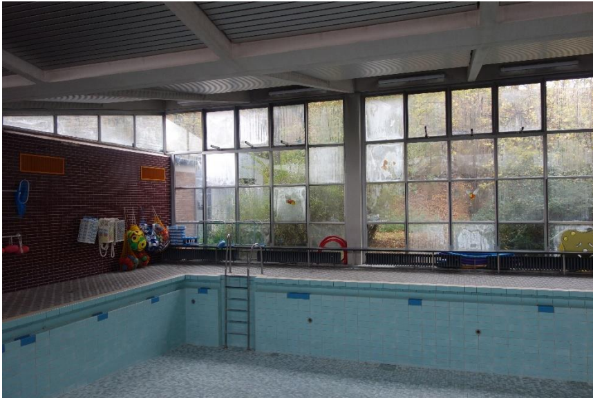
Einblick Lehrschwimmhalle mit erkennbar blinden, defekten Scheiben
