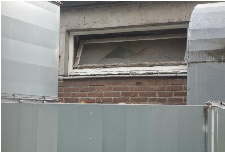
Schadhaftes Holzfenster hinter Lüftungsgerät inkl. defekter Scheibe
